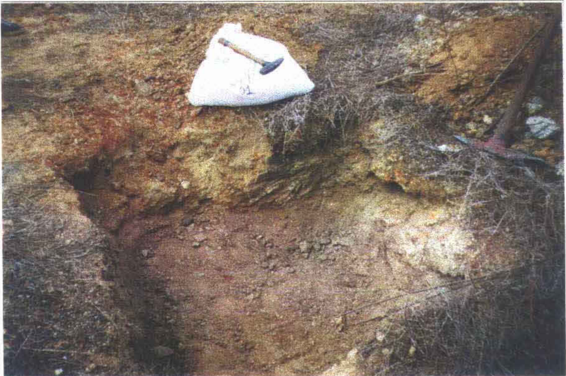
FOTO 01: Estaca E-02/SPP - 01 (ombreira direita).
